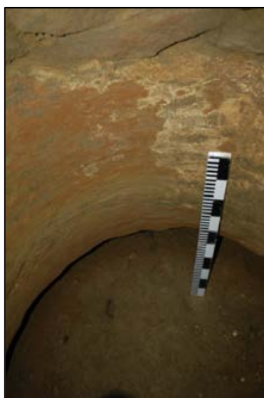
FIG. 20 Kalkaanslag op de ijzerzandsteenlaag.
