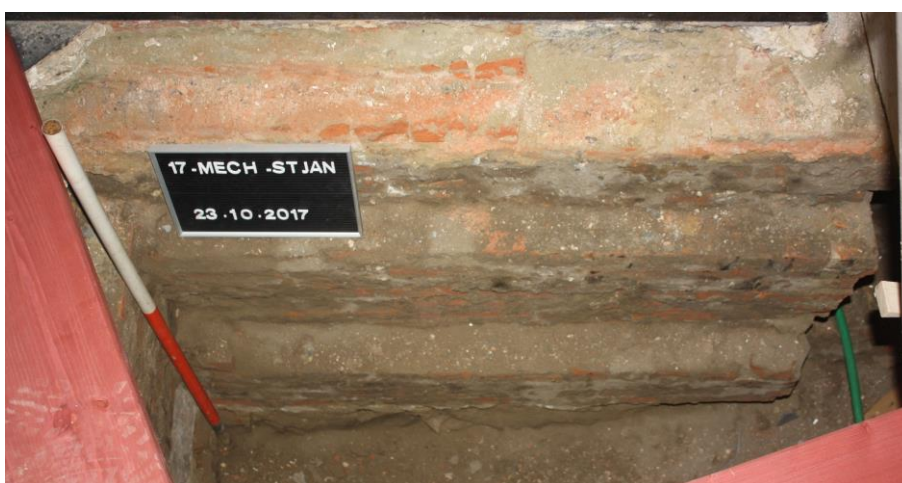
Figuur 8: Fundering 19de-eeuwse grafmonument uitgewerkt in verschillende trappen in de oostelijke collectorput. (© agentschap Onroerend Erfgoed: foto Erwin Meylemans)
