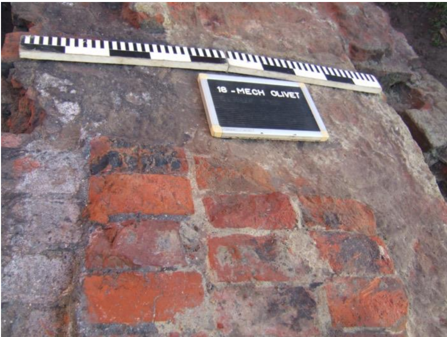
Figuur 22: Detail bovenaanzicht ronde constructie met zicht op gebruikte baksteen en mortel. © agentschap Onroerend Erfgoed. Foto: Marc Brion.
