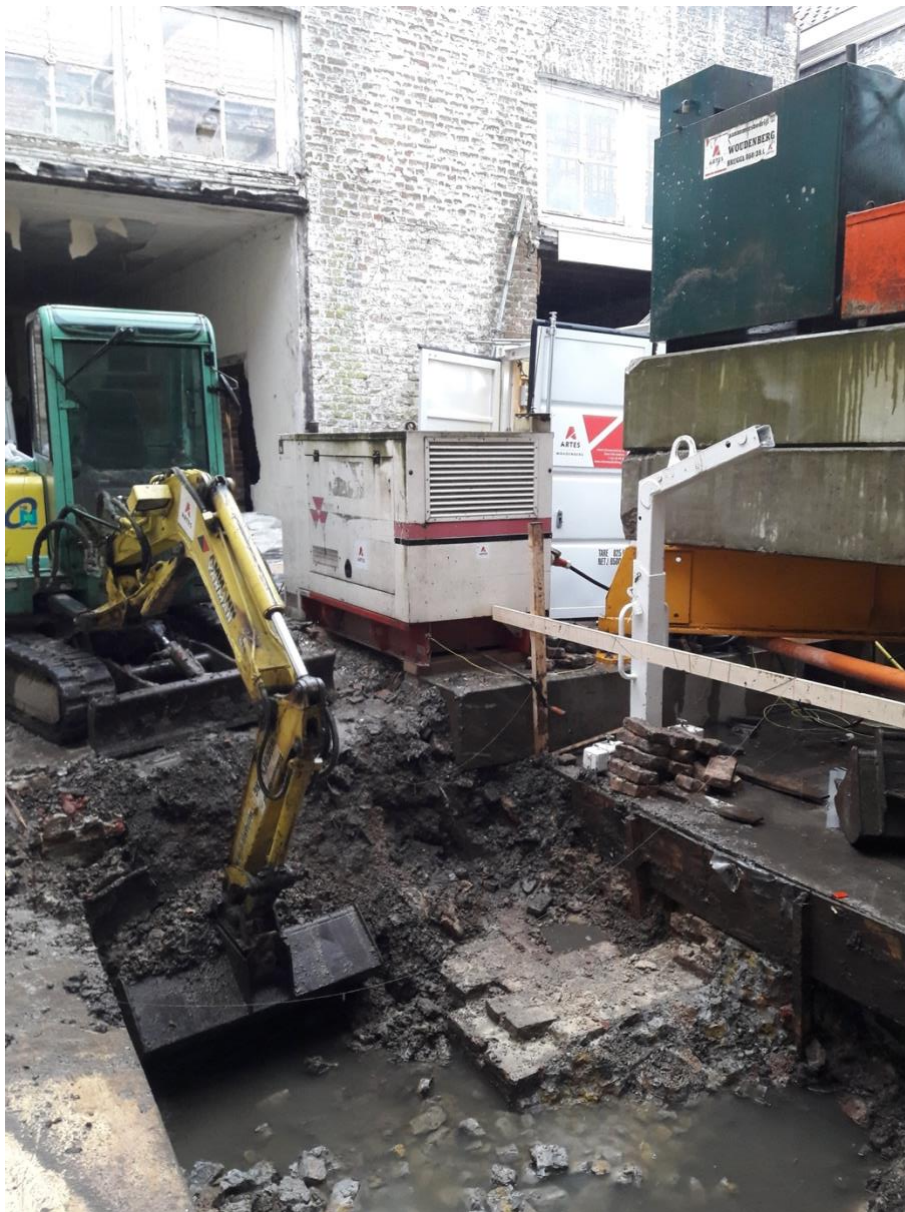
Figuur 4: Op de binnenkoer van het pand, in de werkput voor de aanleg van de liftkoker, stootte de graafmachine op muurrestanten. De boven- en omliggende grond werd vervolgens grotendeels machinaal weggegraven, alvorens de structuur verder manueel kon worden vrijgelegd. Foto Sofie Vanhoutte.
