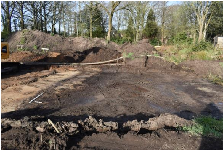
Figuur 4: Toestand op het terrein na het opschaven van de werkput door de graafmachine (© agentschap Onroerend Erfgoed).
