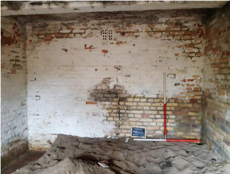
Figuur 12: Zicht op het interieur, vanuit de deuropening. Centraal bevinden zich de ventilatiestenen die verbinding geven met de noordelijke ventilatieschacht (foto: Sam De Decker).
