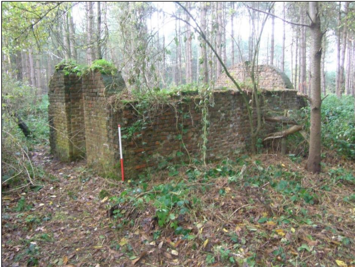
Fig. 6 Bakstenen munitiebunker. De metalen golfplaten van het dak zijn verdwenen.
