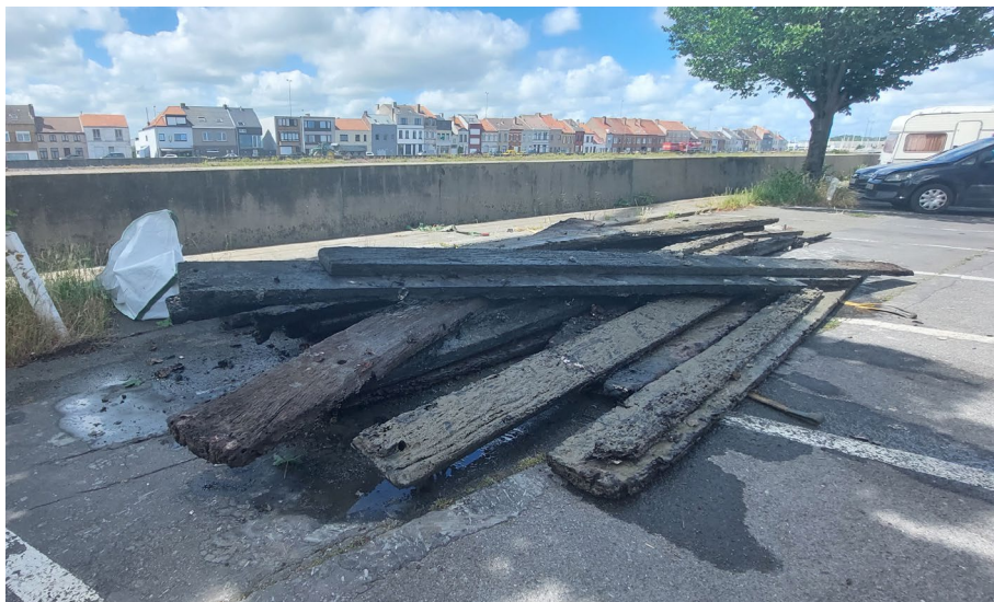
Figuur 46: Geborgen losliggende planken van de sluis ‘Sas Slijkens’, foto 20 juni 2022, foto en copyright MOW – Maritieme Toegang.
