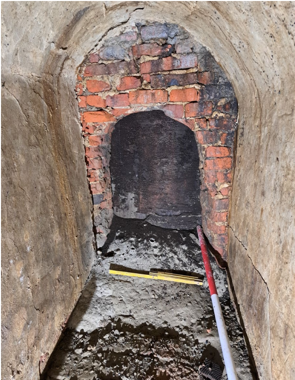
Figuur 14: Dichtgemaakte aansluiting met de waterput, overzicht vanuit het zuidoosten (© agentschap Onroerend Erfgoed, foto: Sam De Decker).
