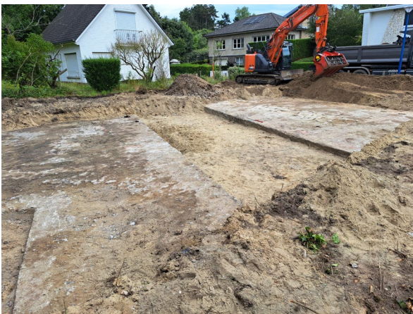
Figuur 15: Opname vanuit het westen, na het uitgraven van de bouwput. © agentschap Onroerend Erfgoed.
