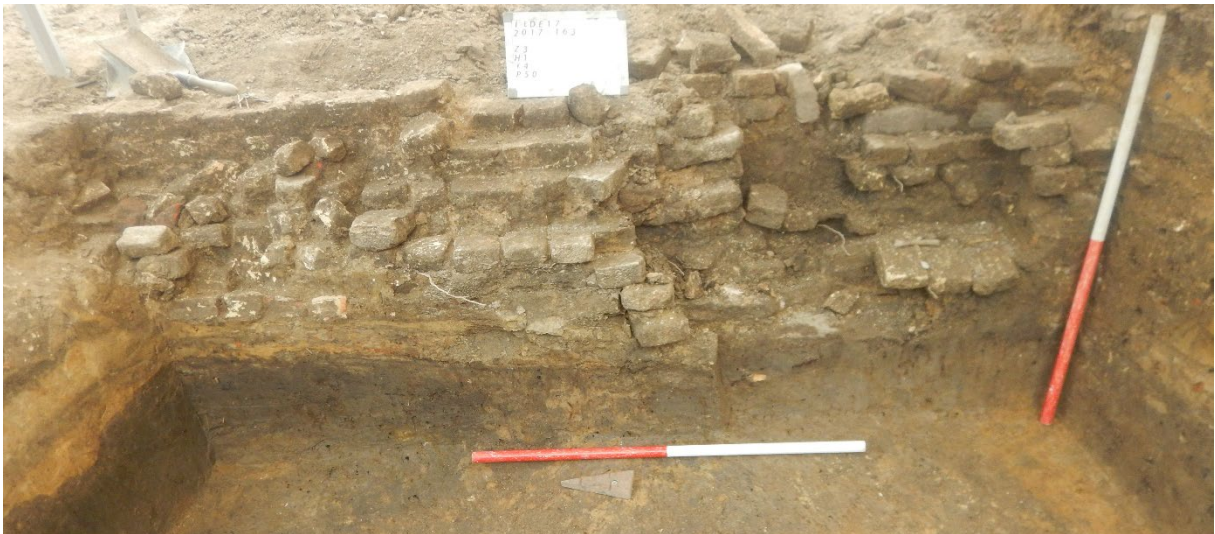
Figuur 6: Fundering in gele baksteen van Huis 1 (H1, kwadrant 4, profiel P50). Foto: Monument-Vandekerckhove.
