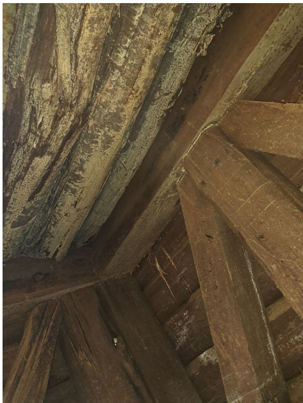
Figuur 15: Binnenzicht op de resterende dakbalken, in vergaande staat van ontbinding. Foto: agentschap Onroerend Erfgoed.
