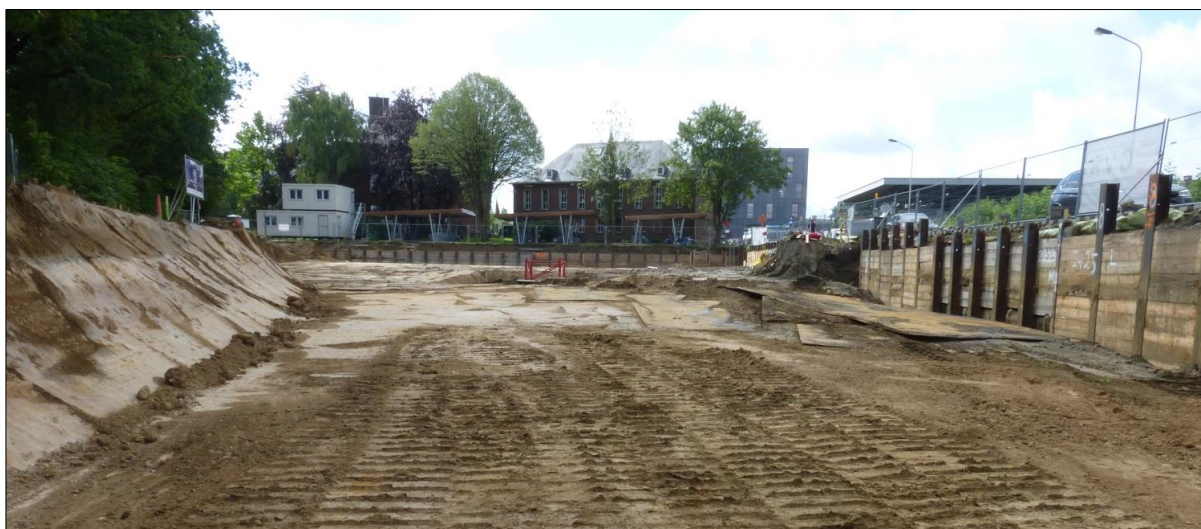
Fig. 3. Zicht vanuit het noorden op de bouwput na het volledig afgraven van fase 1, gefotografeerd vanuit het noordelijk uiteinde van de bouwput. Net achter de bouwput (ten zuiden ervan) is het gemeentehuis van Mortsel zichtbaar, en rechts daarvan het station Mortsel-Oude-God. De Lodewijk Dosfellei loopt enkele meters achter de afsluiting rechts op de foto (ten westen van de bouwput), parallel aan de rand van de bouwput. Uiterst links op de foto is nog net de begroeiing zichtbaar rond Fort 4, onderdeel van de Brialmontgordel.
