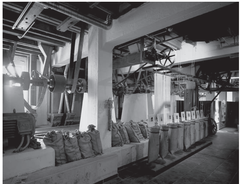
44 De door AEG-elektromotoren aangedreven overbrengingsassen op de gelijkvloerse verdieping van de oostelijke fabriekstoren. Transmission driven by AEG-electric motors on the ground floor.
