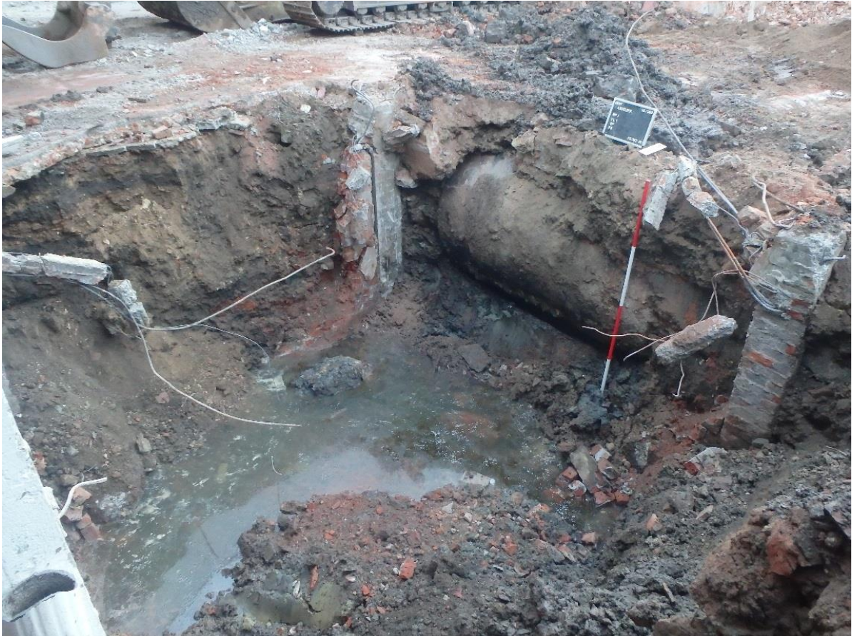
Figuur 22: Uitgebroken kleinere kelder met aanpalende brandstof-tank. Foto richting zuidoost.
