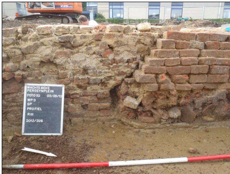
Figuur 54: relatie tussen de bijbouw (links) en de extensie van steunbeer S.3.048.
