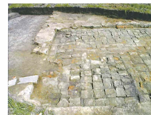
Foto 4.8: Zicht op de vloer in kalksteenblokken, met duidelijke sporen van slijtage, en herstellingen in baksteen (Foto 05-KUHE-0754).
