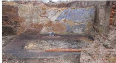
Afb 86 Zicht op de noordelijke kelder muur met ingewerkte ontlastingsboog. Het bezetsel toont duidelijk de plaats van de toegangstrap aan.
