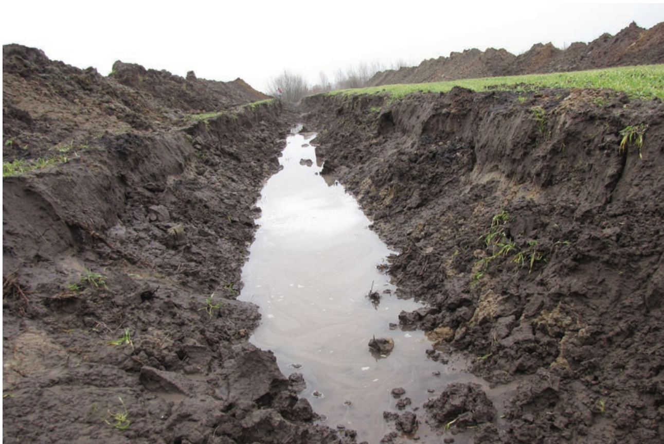
afb. 32: Ingekalfde en ondergelopen sleuf na dooi- en regenweer.
