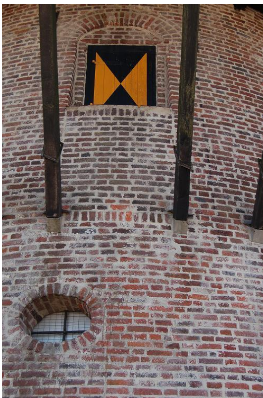
Fig. 21: Zicht op een vorige deur die nu dienst doet als raam en gedeeltelijk dicht gemetst is.
