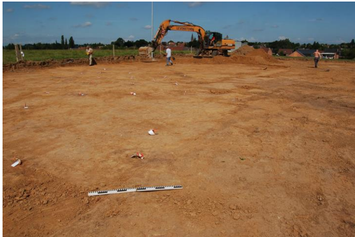
Fig. 4: Kijk op het terrein tijdens het verwijderen van de restanten van de bouwvoor.
