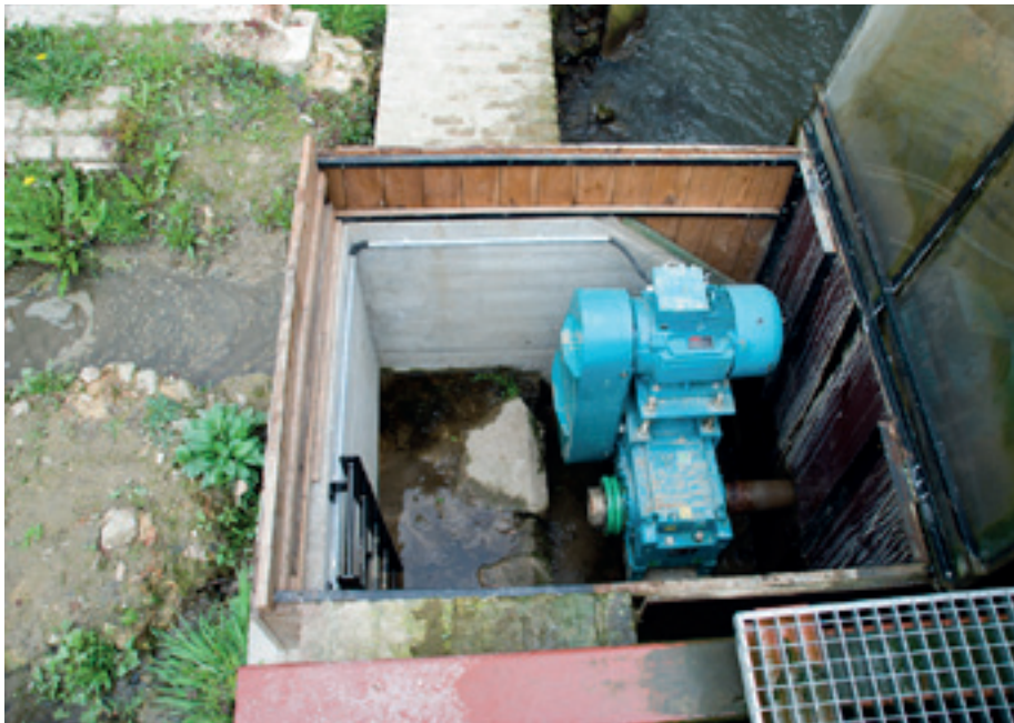
▼ Asynchrone generator Zwalmolen op de linkeroever gekoppeld aan het waterrad.
