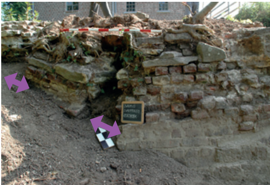
▲ De diepe scheuren en verzakkingen illustreren de instorting en teloorgang van het gebouw.
