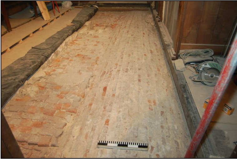
Fig. 17: kijk op het bakstenen gewelf en vloer in het noordelijk deel van de sacristie.
