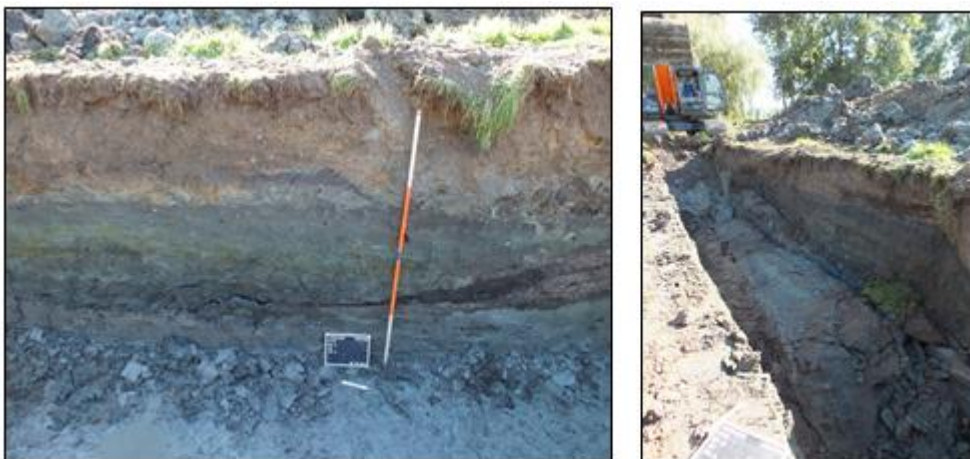
Figuur 25: Profiel 6 in WP 2 (links), ingestort (rechts).
