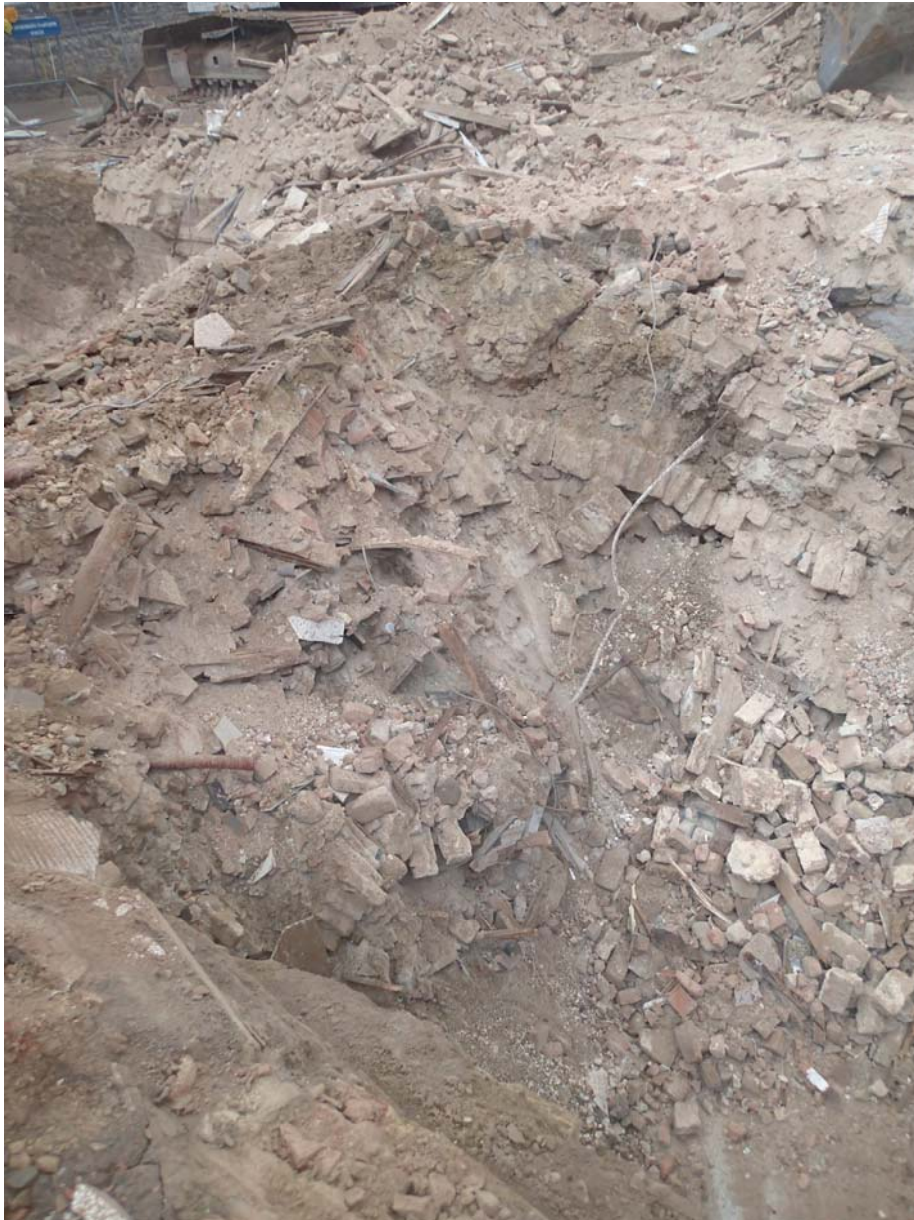
Fig. 2.1: De toestand van de middelste kelder aan de zijde van de Hennemarkt.
