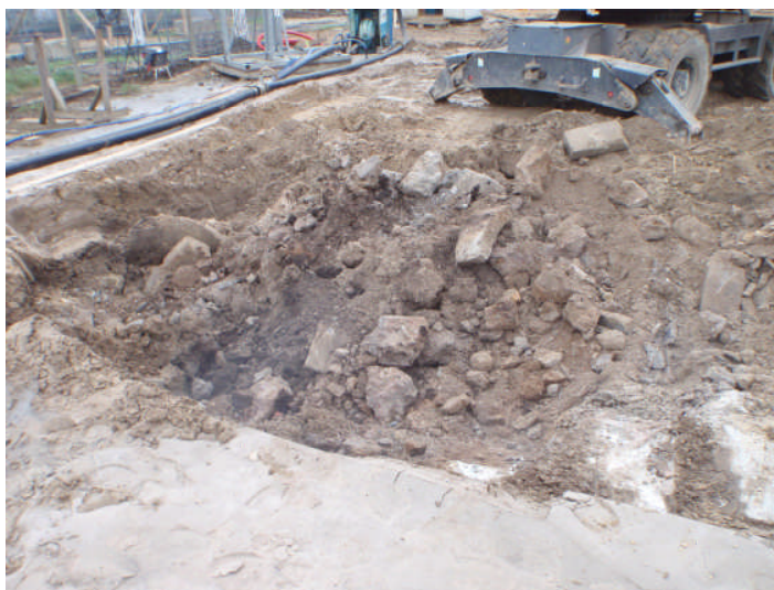
Afbeelding 7: dik puinpakket onder het maaiveld
