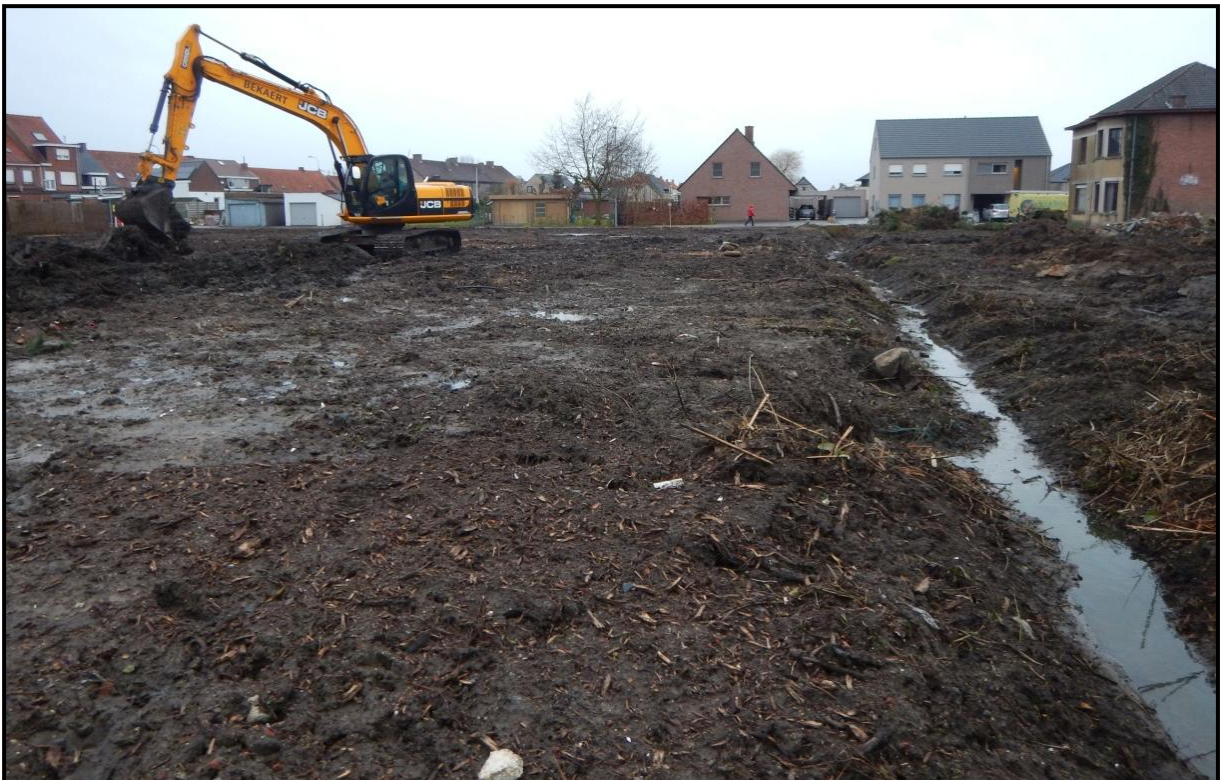
Figuur 8: Zicht op de ca. 1m brede O-W georiënteerde recent gegraven afwateringsgracht centraal op het terrein met rechts in beeld nog de aanwezige bebouwing en afbraakpuin.
