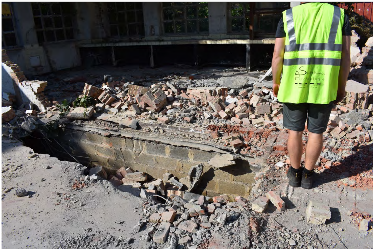
Fig. 3.15: Foto van een (ingestorte) kelder op het terrein.
