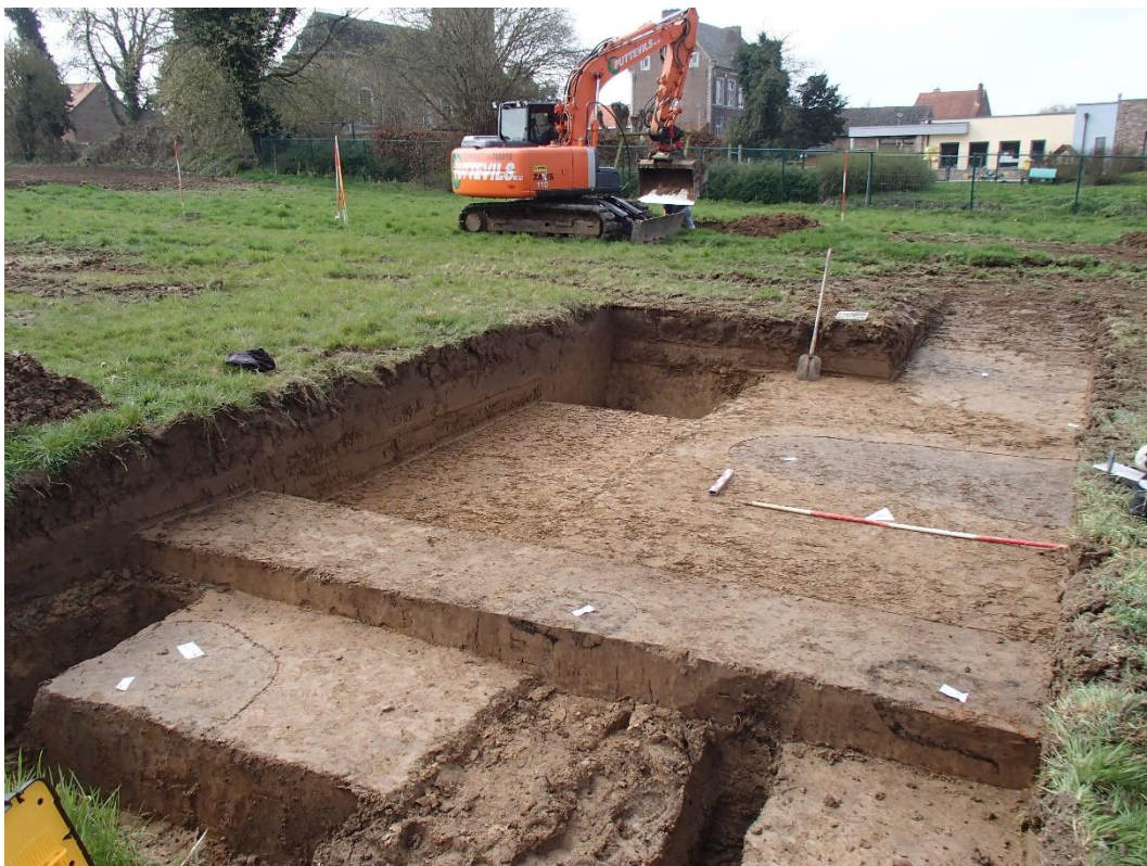
Figuur 12. Zicht vanuit het noordoosten op werkput 1. In de voorgrond bevindt zich de proefsleuf uit 2015, met de reeds gecoupeerde sporen. De (sub)recente sporen S101 en S102 tekenden zich reeds op een hoger niveau af, waardoor ten westen van de proefsleuf uit 2015 een bankje is blijven staan.
