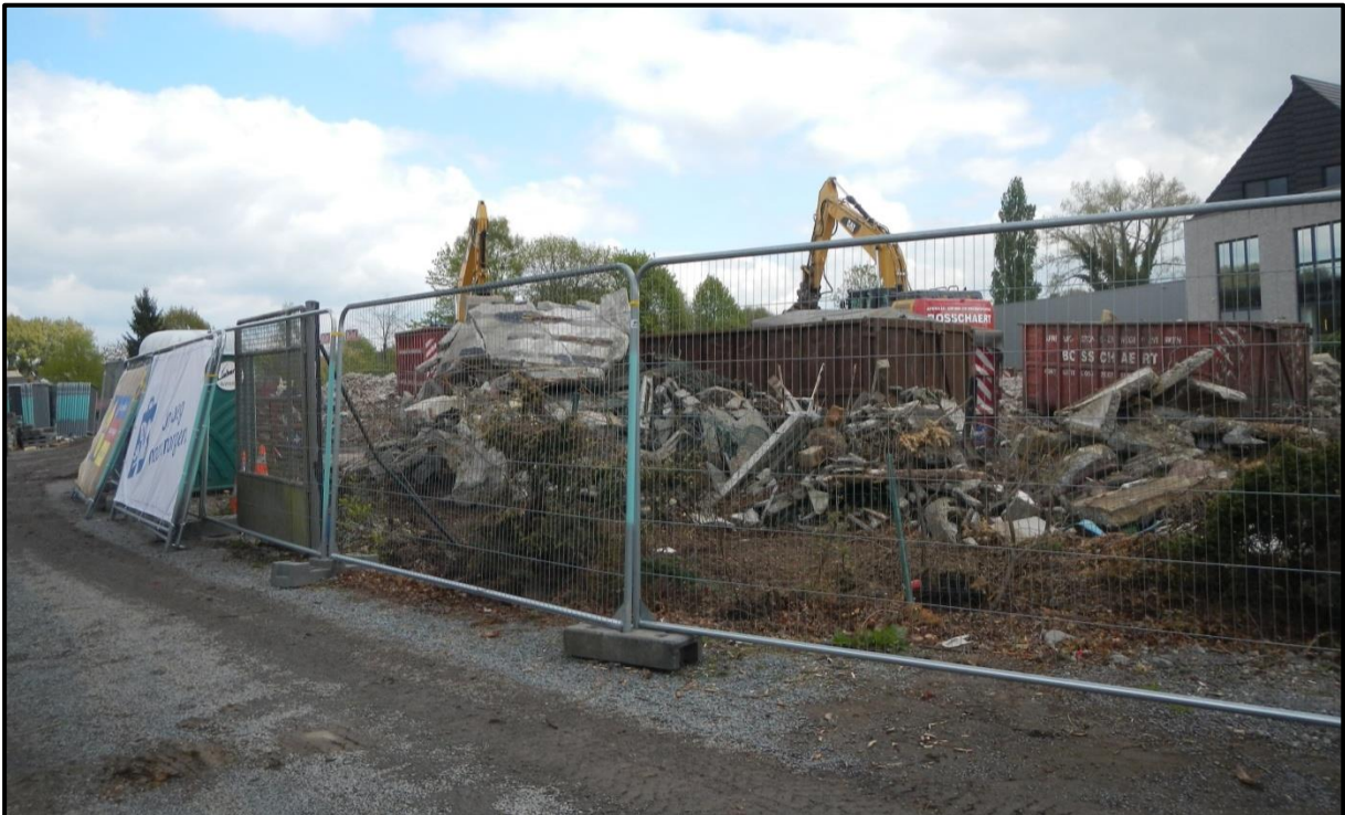
Figuur 18: Zicht op de afbraakwerken van aan de straatkant. Een sleuf graven aan de straatzijde was door de werken niet mogelijk.
