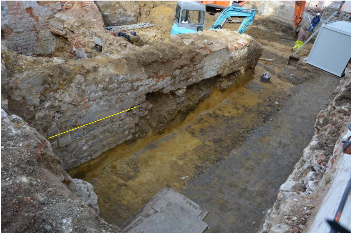
Fig. 3.20: Ondermetseling van muur S1.
