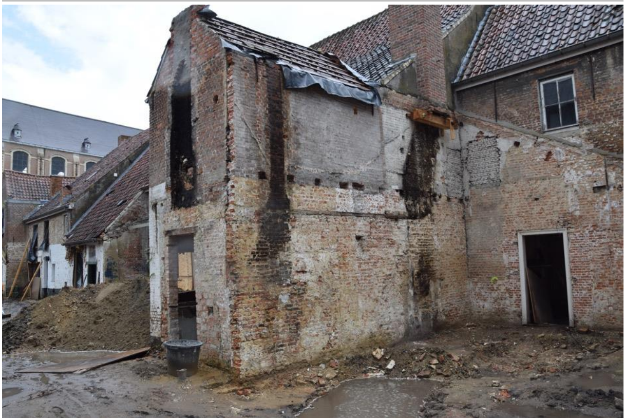
Fig. 4.29: Roetaanslag van 3 schouwen op zuidwestgevel van ruimte 8.6.
