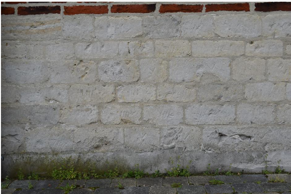
Fig. 4.12: Sint-Martinuskerk, Wilsele: plint noordzijde koor met van boven naar onder rijen met de merken V, III-, V, IIII, III-, V en helemaal onderaan een bepleisterde laag stenen.
