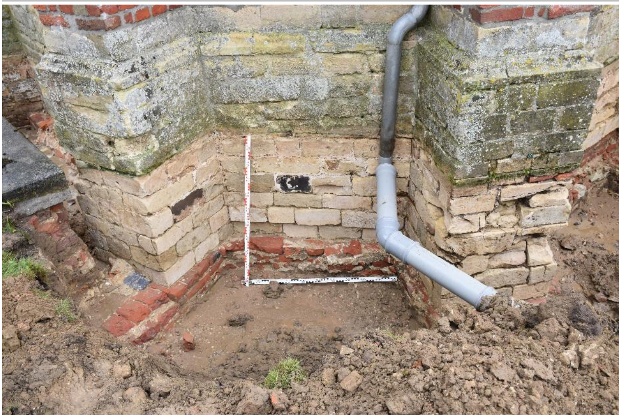
Fig. 4.9: Afwijkende fundering in koorafsluiting
