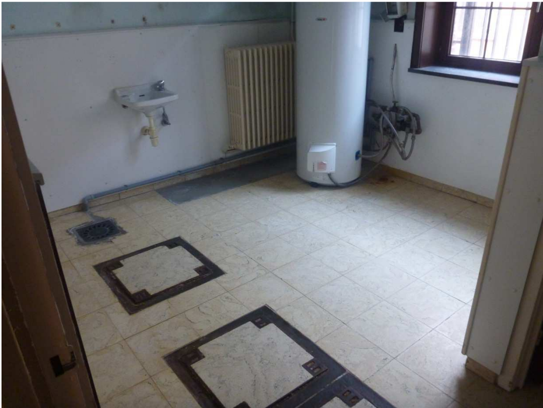
Figuur 22: foto van een ruimte binnen het gebouw met putdeksels en afvoerbuïs
