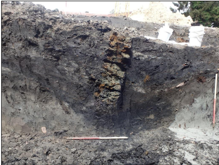
Figuur 78: Fundering S2118 van de achtergevel van de oudste fase. Deze muur werd aangelegd in de instabiele vulling van kuil 2116. Ondanks de diepte van de funderingsmuur, was deze toch verzakt
