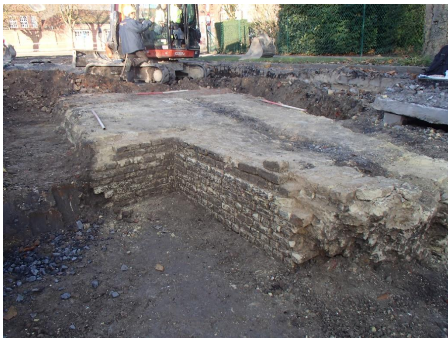
Figuur 33: De Hollandse vestingsmuur S.2.1.006 in het vlak, met voorin één van de steunberen en links een uitbraakspoor ontstaan bij de recente aanleg van nutsleidingen
