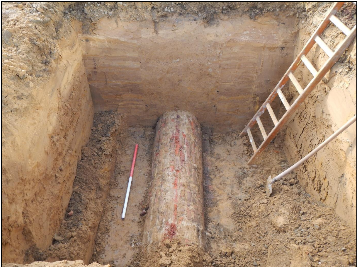
Figuur 41: zicht op riolering S64; In het profiel is de opgevulde aanleg sleuf duidelijk te zien.
