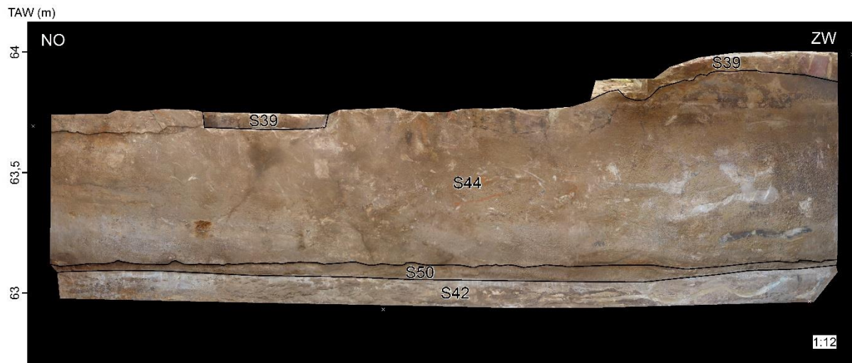
Figuur 50 Binnenzijde waterreservoir S042.
