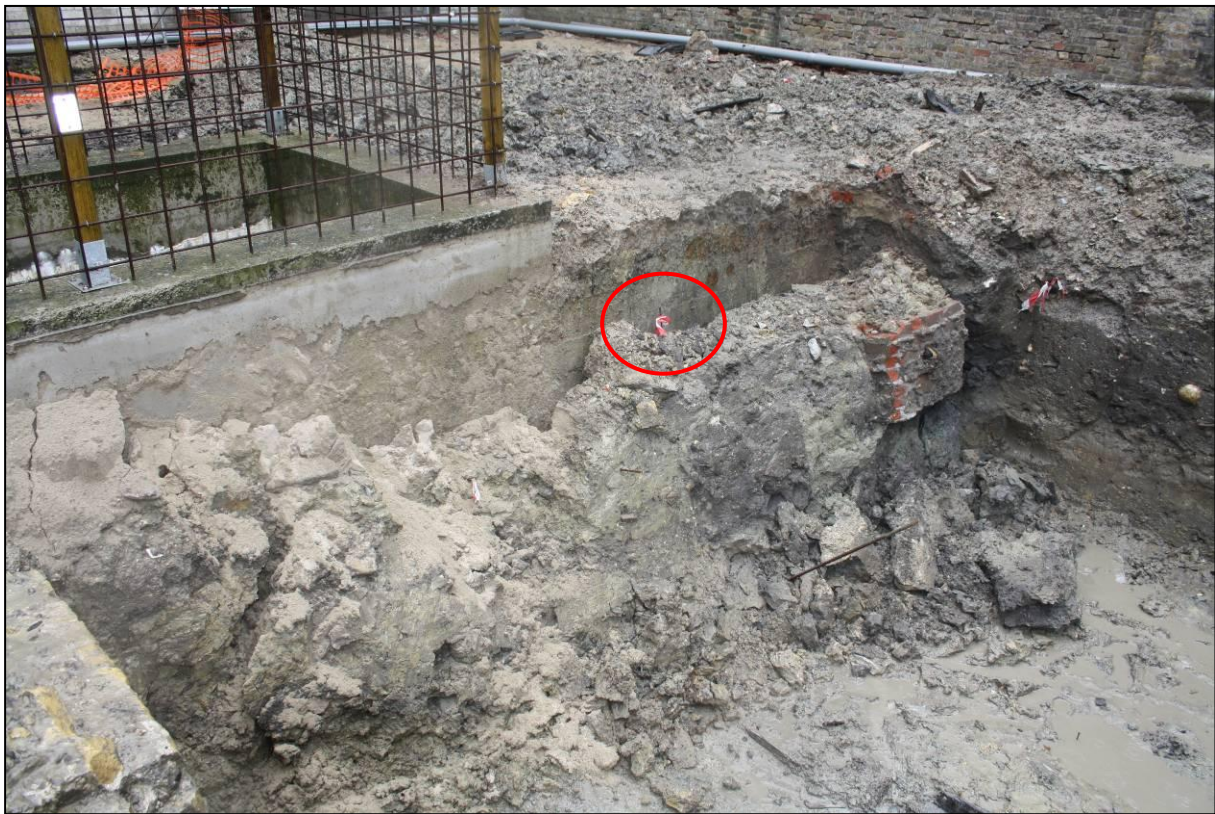
Figuur 17: Toestand na het instorten van het westprofiel (P4) in werkput 1 waarbij eveneens een meetpunt verdween (rode cirkel).
