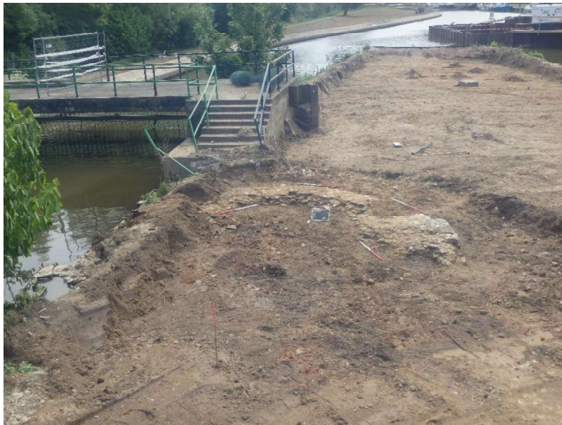
Figuur 55: Centraal-zuidelijk deel van het oostelijke stuweiland, met de restanten van de Pijntoren die dagzomen.
