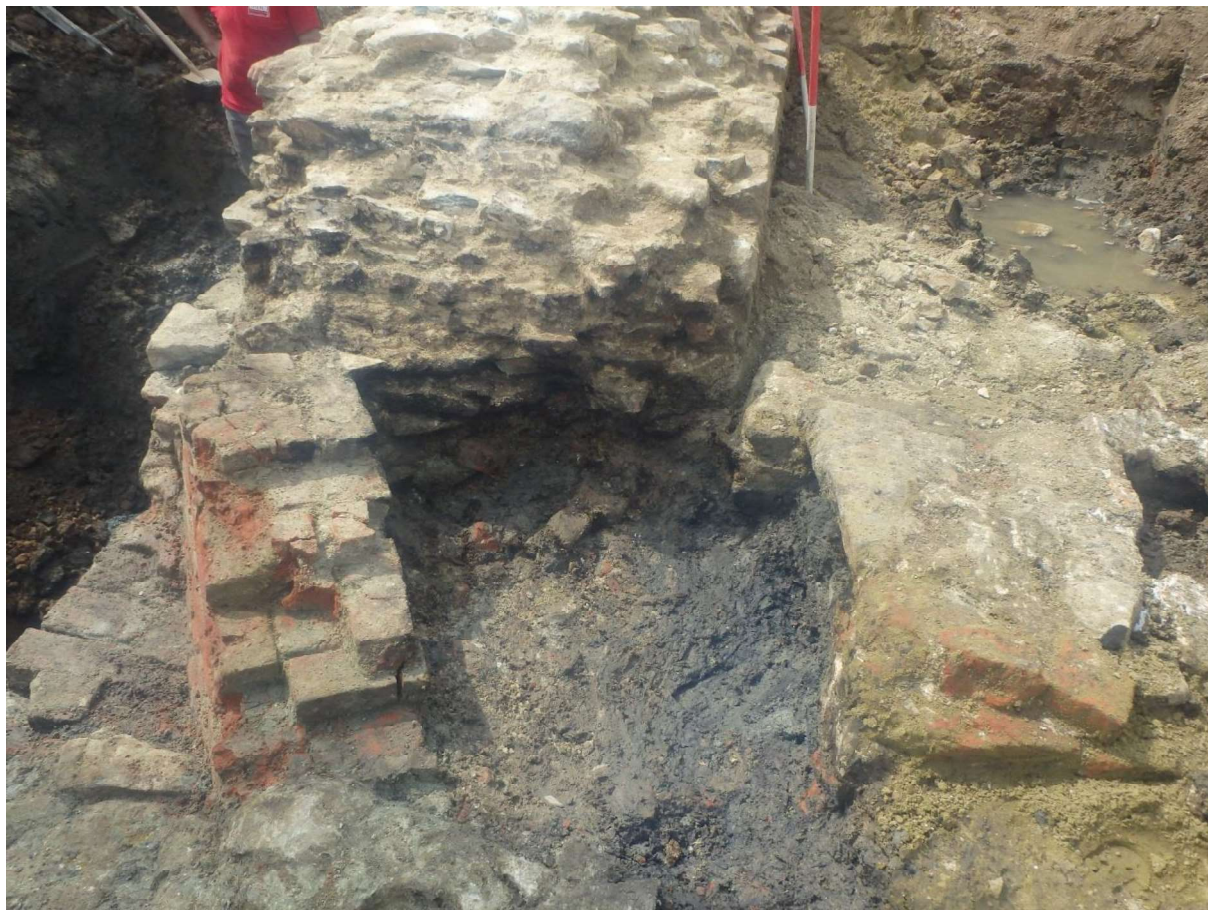
Figuur 102: Detailfoto van stadsmuur 1039, met rechts goot 1066 en links de schuin ten opzichte van de stadsmuur lopende muur 1067.
