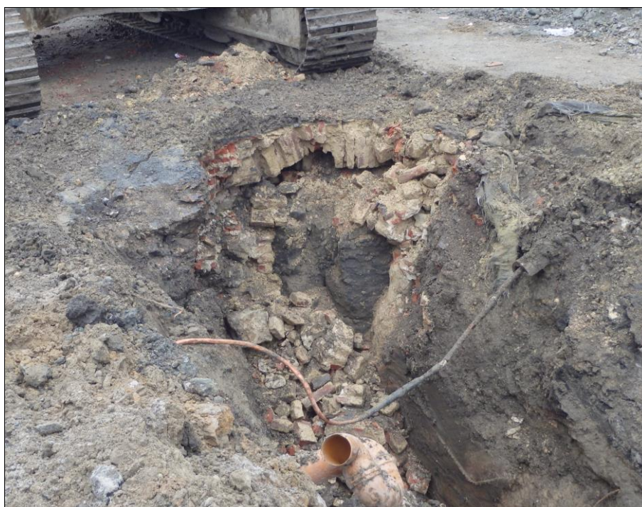
Figuur 33: Foto van de bakstenen structuur wanneer deze voor de eerste maal werd aangesneden in de rioleringsleuf. Door de nabijheid van kabels en leidingen en het gevaar op instorten van de sleufwand, kon de structuur niet in detail worden gedocumenteerd. Op deze foto is het gewelf duidelijk zichtbaar (BAAC, 2015).
