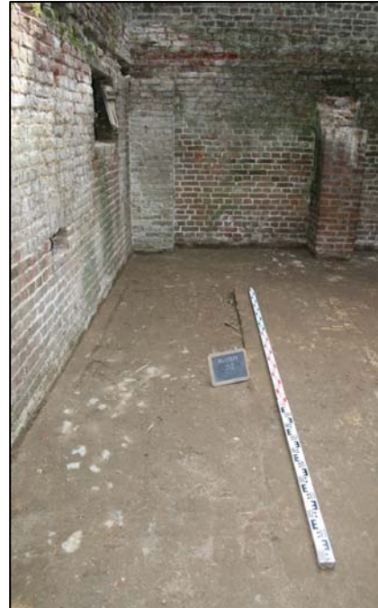
Figuur 42 : Verzakking in de bakstenen vloer
