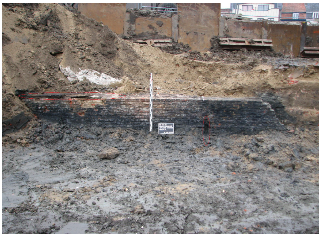
Afb 6: Muur 21 met houten plank (links) en muuranker (rechts)
